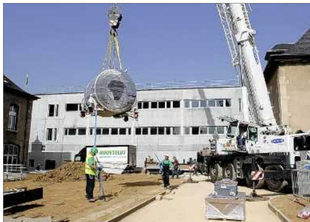
Titan, la nouvelle IRM, est un beau bébé doté d'un aimant de 5 tonnes, déposé délicatement en passant par le toit, à l'aide d'une grue. Photo: Colilde VERDENAL
